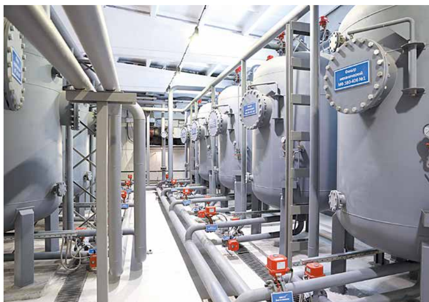
Постоянное развитие — незыблемый приоритет Распадской угольной компании. Одним из таких примеров стало полное техническое перевооружение очистных сооружений хозяйственно-бытовых стоков шахты «Распадская»
